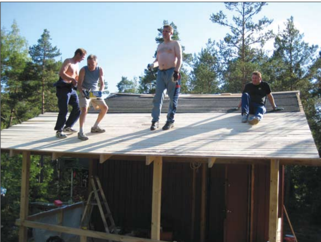
Kuistin katolla. Rantalan mökkeihin on rakennettu terasseja. Kuvassa rakennustalkoissa terrassin katolla Jari Sunila, Heikki Liukkonen, Rantalan isäntä Ari Toimio ja Kari Laaksonen. Lisää Rantalasta sivulla 6.
